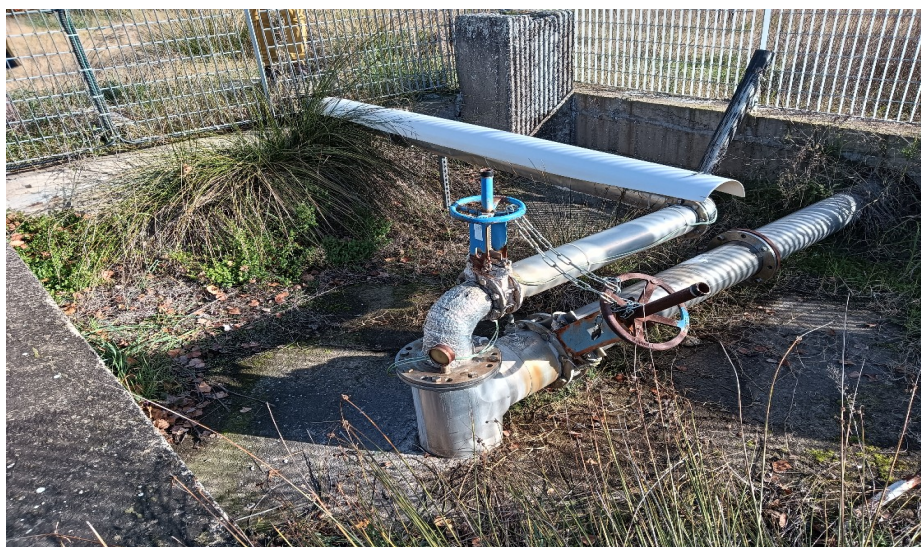
Interno area recintata: opera di presa con adduzioni acqua termale
