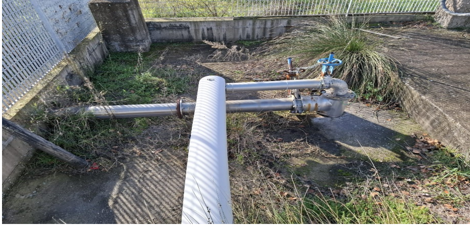
Interno area recintata: opera di presa con adduzioni acqua termale
